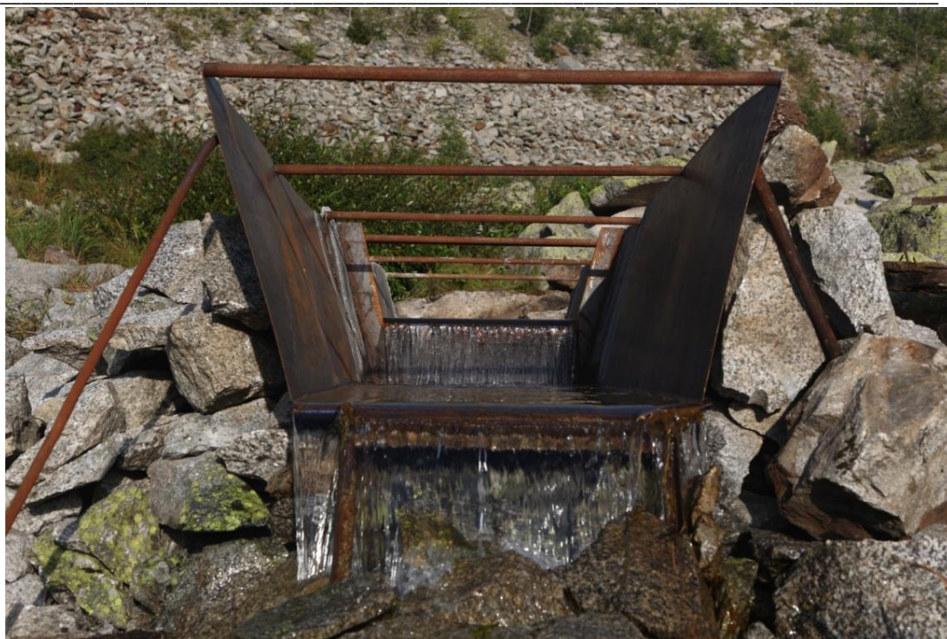
Рис.8. Гидрометрический лоток для замера дренажного стока в нижнем бьефе ПЛОТИНЫ.
