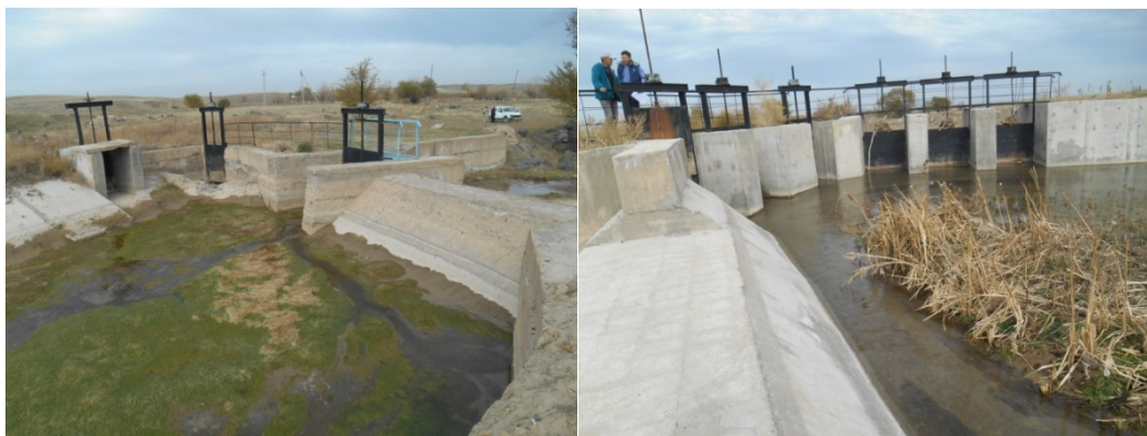
Рис.5. Малые гидроузлы. Верхний бьеф. Особенность малых гидроузлов это простота управления, частое заилиение подводящего русла.
