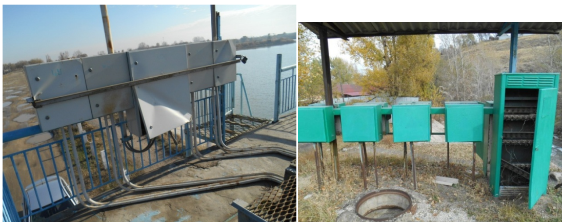
Рис. 9. Пульты автоматического управления затворами.
